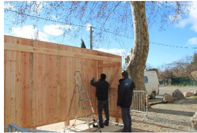
Réalisation de la cloison de séparation entre l'abribus et l'abri pour le terrain de pétanque.
