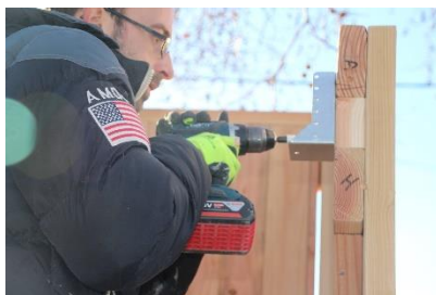
Fixation des sabots de réception des poutres de la charpente en vue du placement de plaques sous tuiles (PST).
